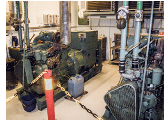
Dieselgeneratorer kunde förse fortet med el
