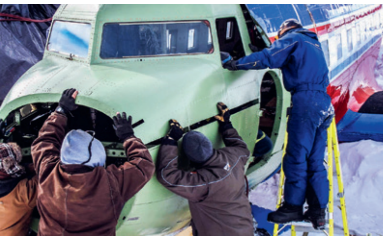
Det skadade nospartiet har avlägsnats och alla hjälper till att få nya nosen på plats.
